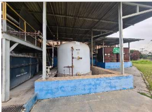
Estação de tratamento de efluentes
