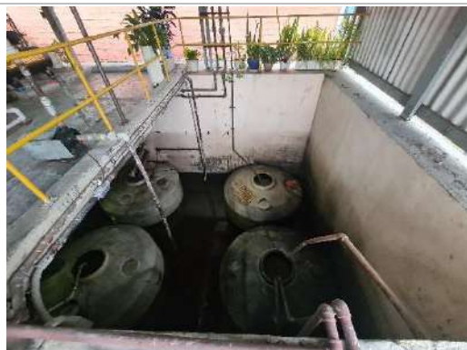
Estação de tratamento de efluentes
