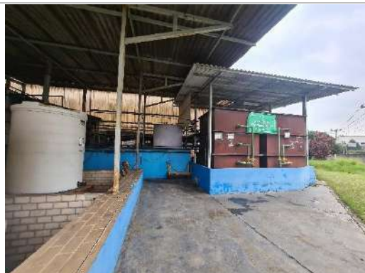
Estação de tratamento de efluentes
