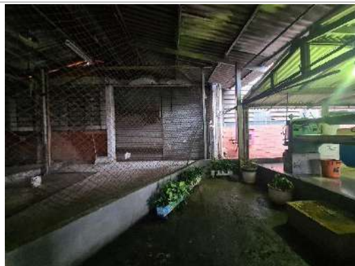
Estação de tratamento de efluentes
