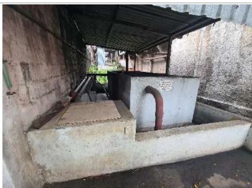
Reservatório de água de reuso
