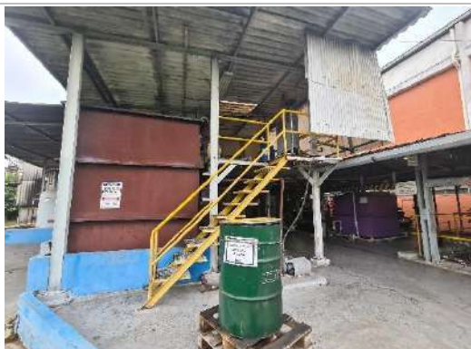
Estação de tratamento de efluentes
