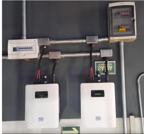
36 Kit gerador de Energia Solar Fotovoltaica
