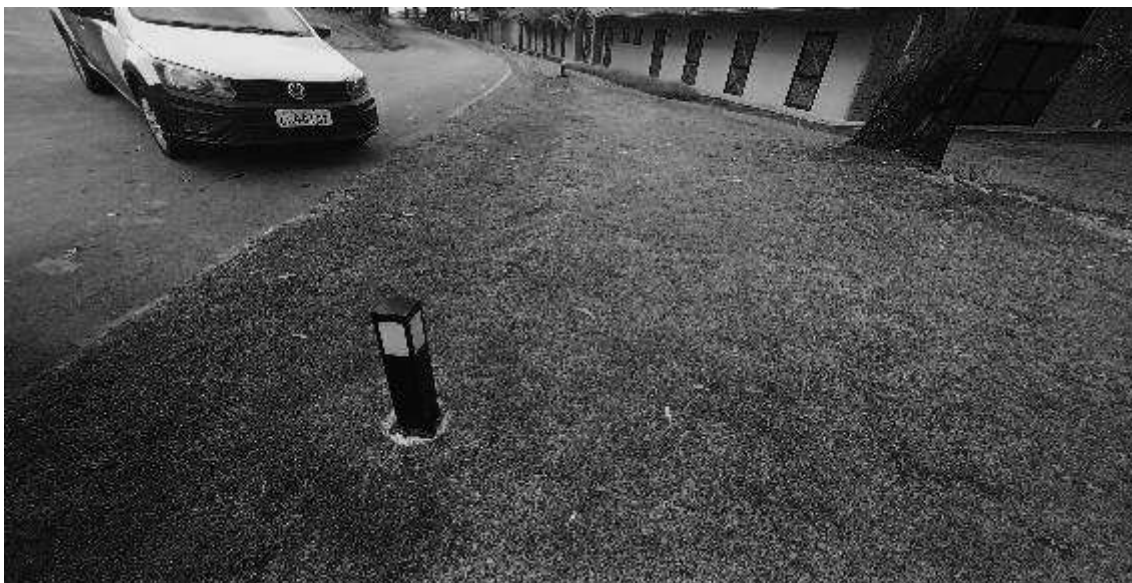
Detalhe de colagem de balizador com base quebrada, melhorias.
