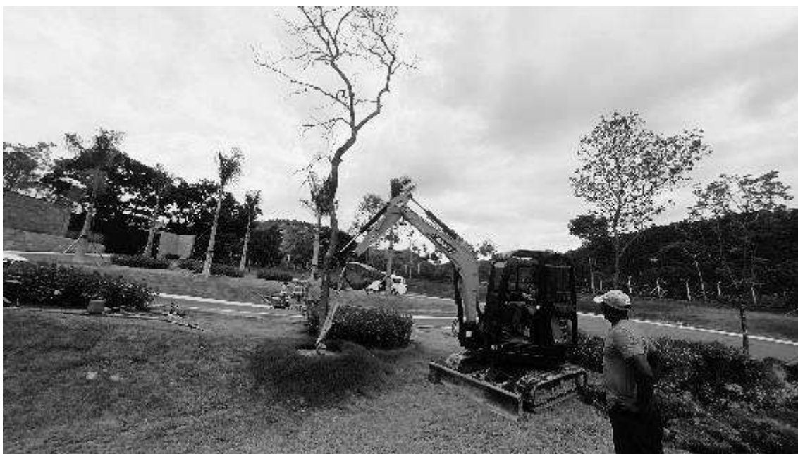
Detalhe de remoção de arvores mortas, Ipês e jacarandá, plantio para amanhã.
