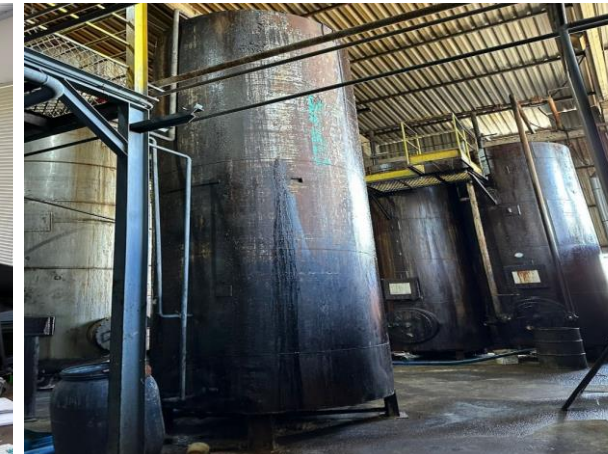
Tanques de armazenamento/produção.
