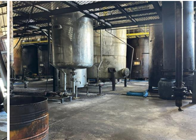
Tanques de armazenamento/produção.
