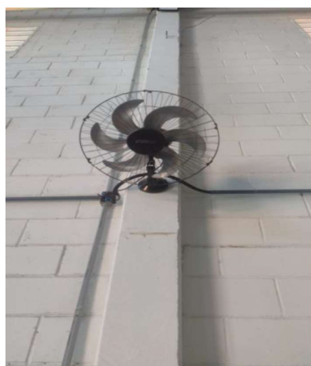
Vista geral Ventilador
