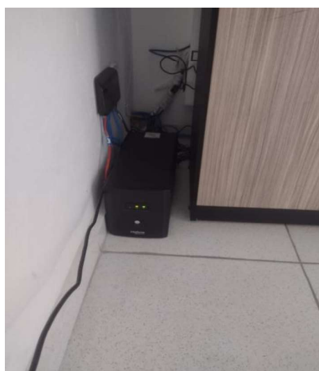
Vista geral Nobreak
