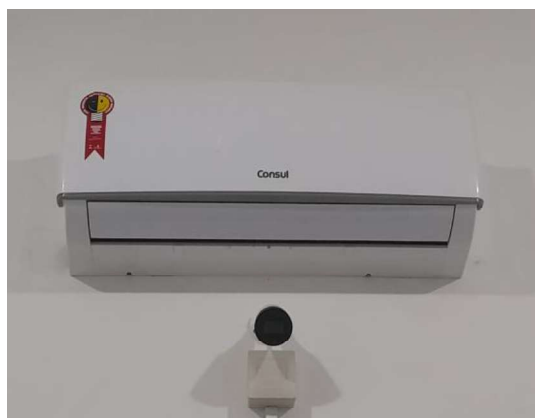
Vista geral Ar Condicionado 9000
