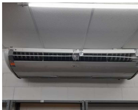
Vista geral Ar Condicionado 60000
