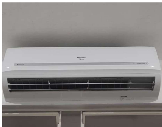
Vista geral Ar Condicionado 33000
