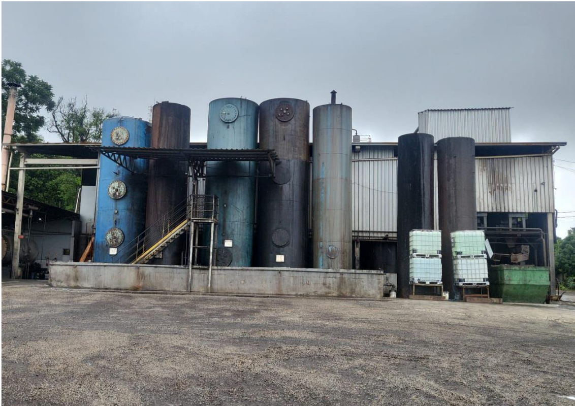
Foto tanques (acervo da empresa)
