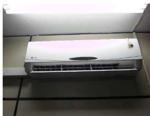
Figura 35 – Qtd 01 – Aparelho de Ar Condicionado 18.000 BTUS - Tr
