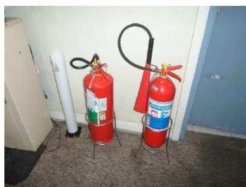
Figura 27 – Quantidade 04 – Extintores de Incêndio
