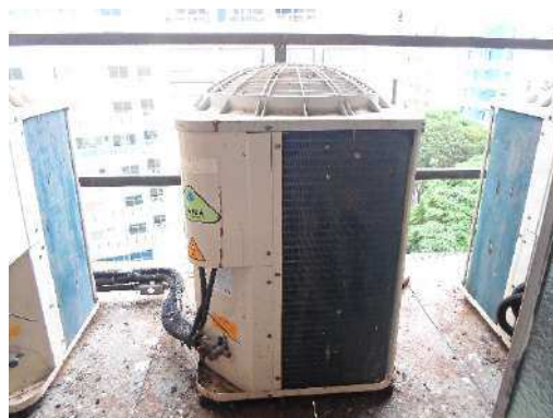
Figura 13 – Qtd 05 - Maquinas de Ar Condicionado 58.000 BTU
