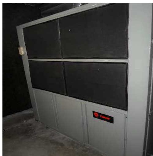
Figura 33 – Qtd 01 – Equipamento de Ar Condicionado Trave 35 TB
