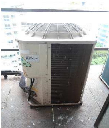
Figura 36 – Qtd 05 – Aparelho de Ar Condicionado 58.000 BTUS Itachi
