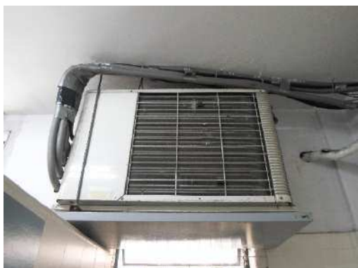
Figura 14 – Qtd 05 – Aparelho de Ar Condicionado 18.000 BTU
