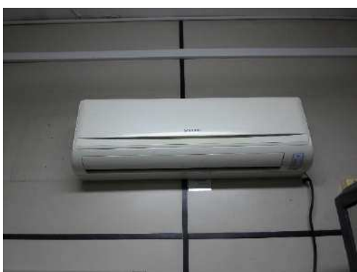
Figura 32 – Qtd – Aparelho de Ar Condicionado 2400 BTUS – Slip Trane
