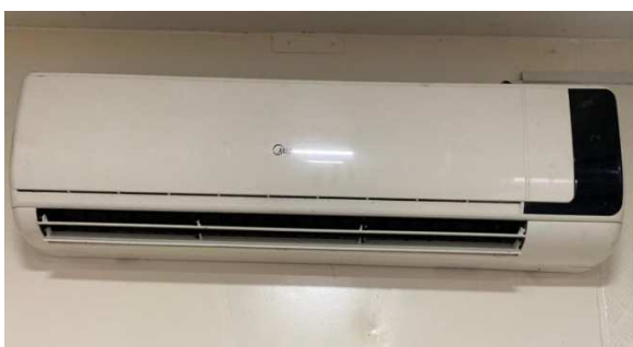
Foto 08 – 2 unidades - Condicionador Climatizador para 500 mts, Climabrisa EV50 $PT 6HI – R$ 37.658,94
