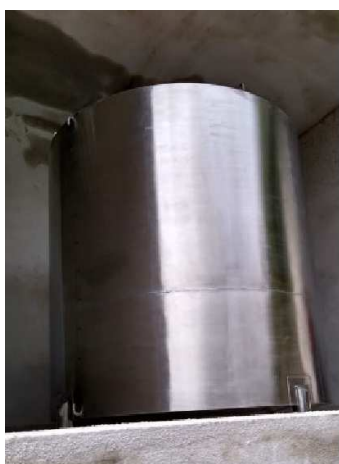
Foto 26 - CAIXA DA AGUA METALICA E BASE – R$ 37.333,44
