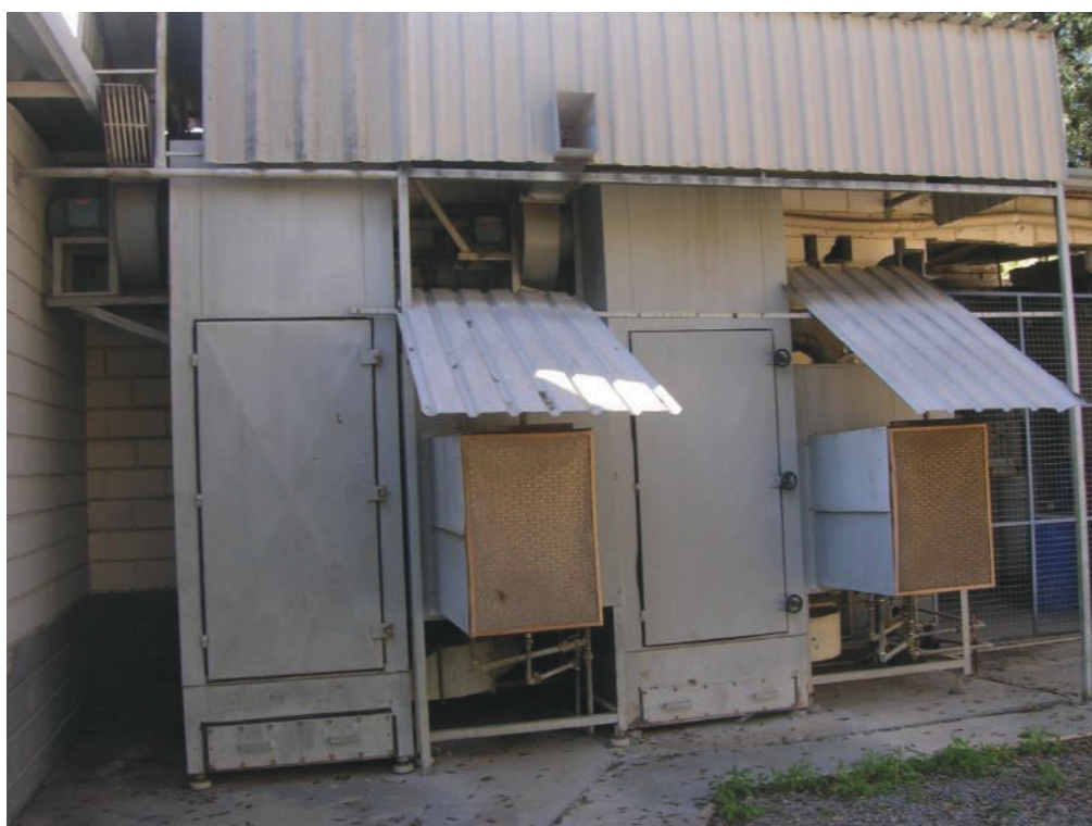
ITENS 1,243 / 1,244 - CLIMATIZADORES COM CAIXA DE FILTROS ACOPLADA
