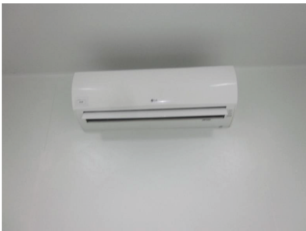
ITEM 1,174 - AR-CONDICIONADO SPLIT LG 17.000 BTUS
