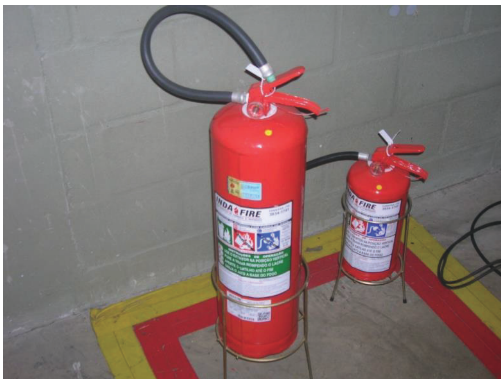
ITENS 1,032 / 1,033 - EXTINTORES DE PÓ QUÍMICO E ÁGUA
