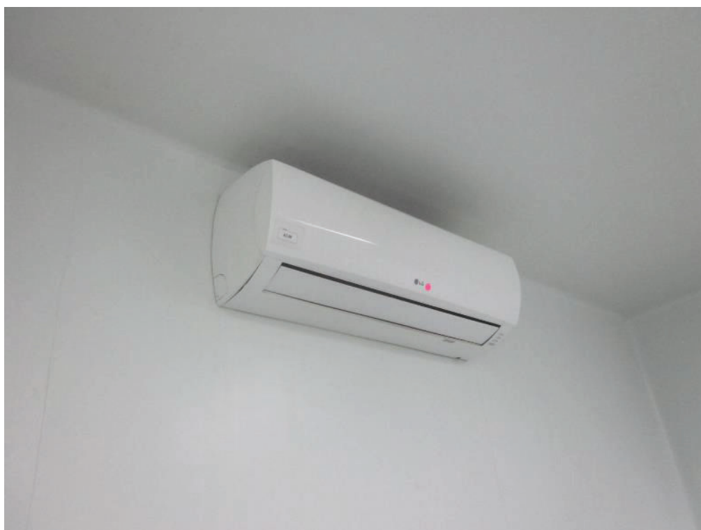
ITEM 1,166 - AR-CONDICIONADO SPLIT LG 17.000 BTUS
