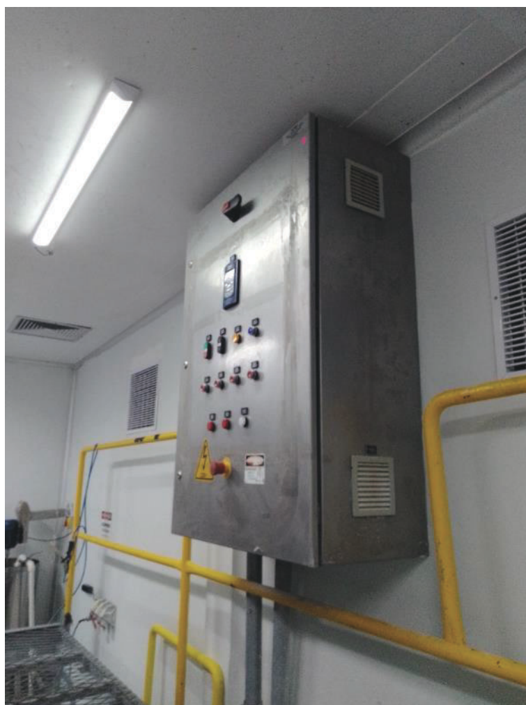
ITEM 1,584 - PAINEL DE COMANDO DO MISTURADOR EM INOX REVIMAQ IHM CFW700
