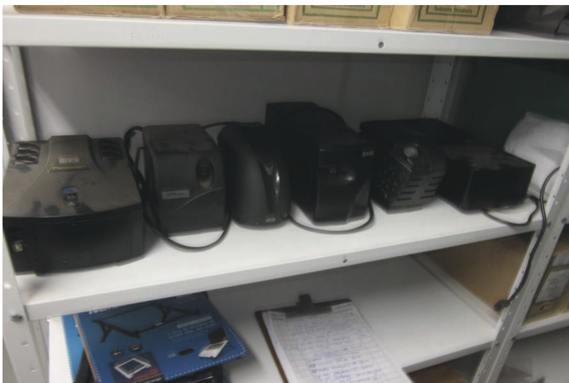
ITENS 1,997 / 1,998 / 1,999 / 2,000 / 2,001 / 2,002 - NOBREAK WEG PERSONAL 1,2 KVA E ESTABILIZADORES DE TENSÃO DIVERSAS MARCAS, MODELOS E CAPACIDADES
