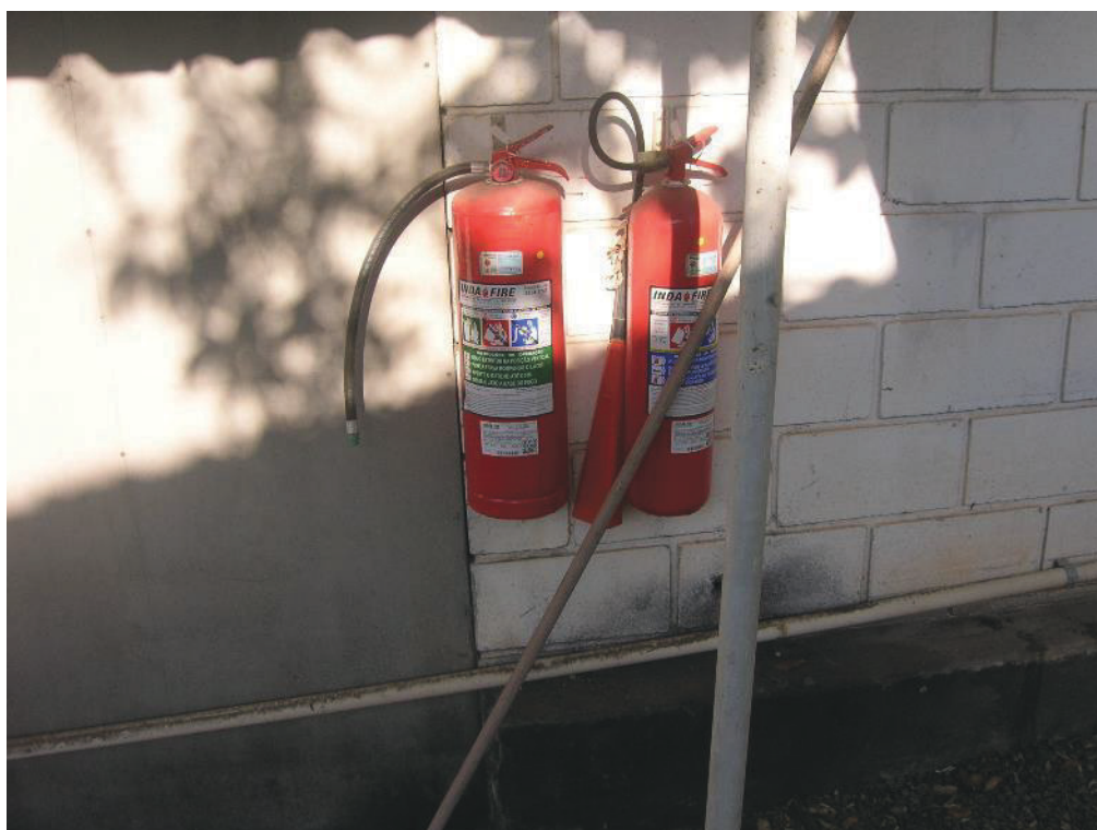
ITEM 1,276 - EXTINTORES DE CO2
