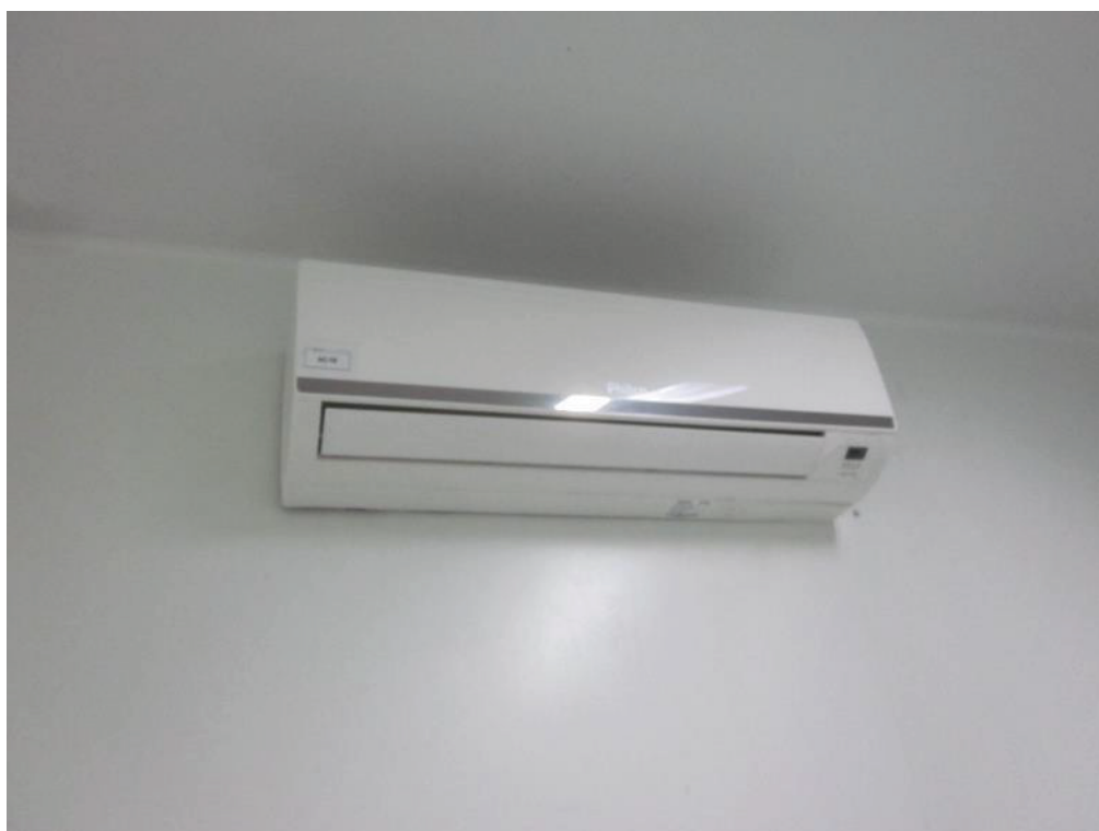
ITEM 1,086 - AR-CONDICIONADO SPLIT PHILCO
