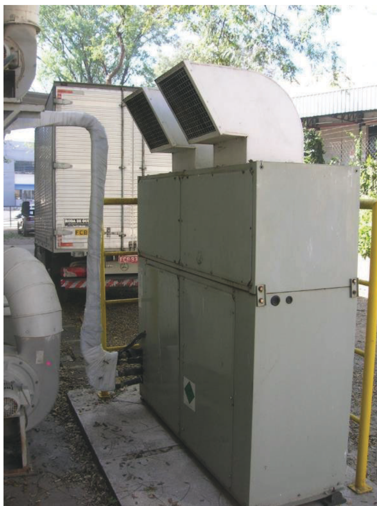
ITEM 1,226 - UNIDADE CONDENSADORA TRANE
