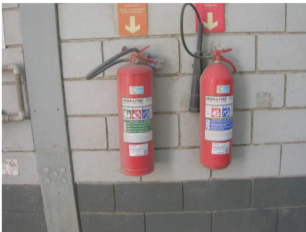
ITENS 1,230 / 1,231 - EXTINTORES DE ÁGUA E CO2
