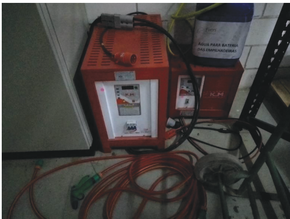
ITENS 1,283 / 1,284 - CARREGADORES DE BATERIAS KM
