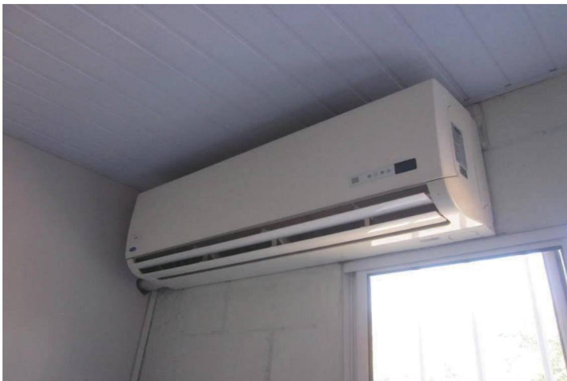
ITEM 1,675 - AR-CONDICIONADO SPLIT CARRIER 22.000 BTUS
