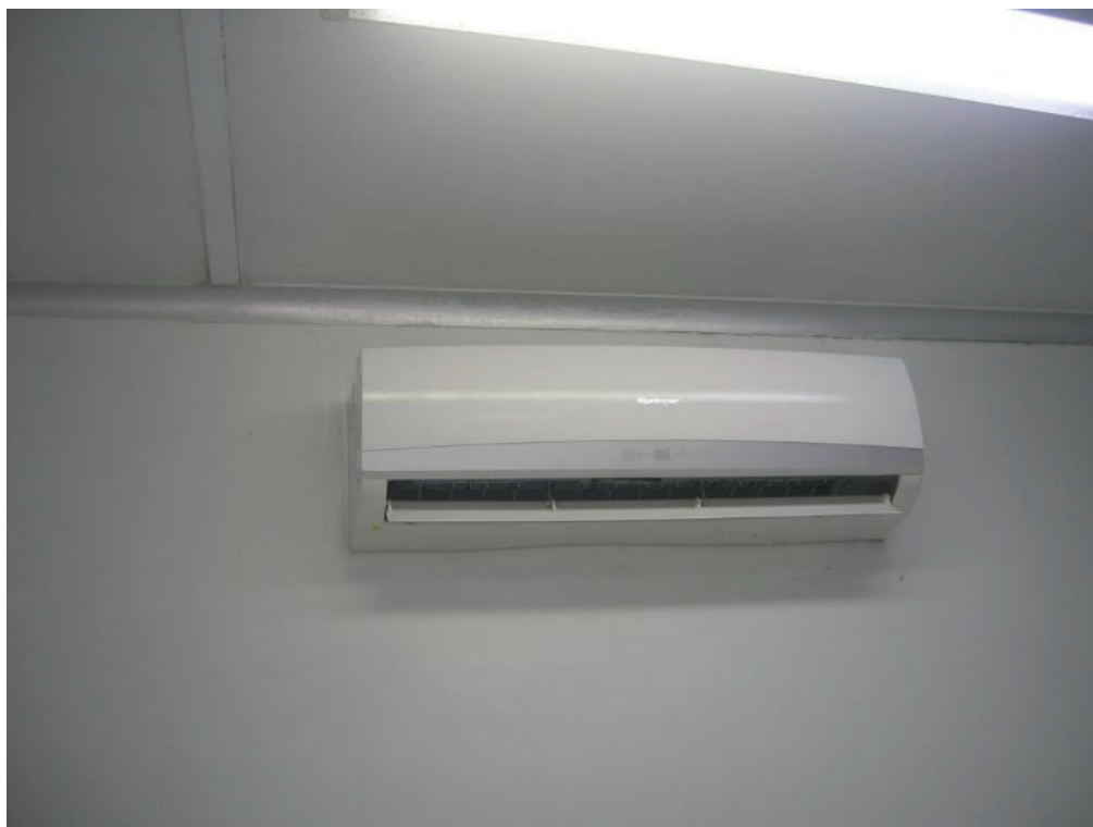
ITEM 1,442 - AR-CONDICIONADO SPLIT CARRIER 18.000 BTUS
