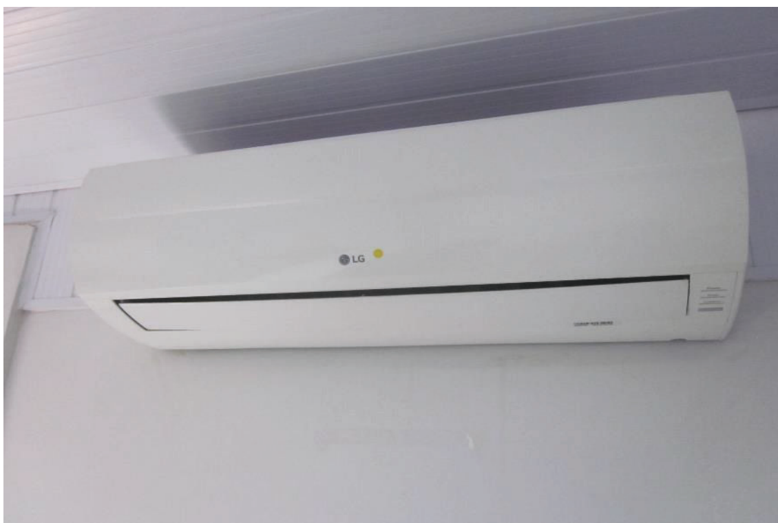
ITEM 1,884 - AR-CONDICIONADO SPLIT LG 17.000 BTUS
