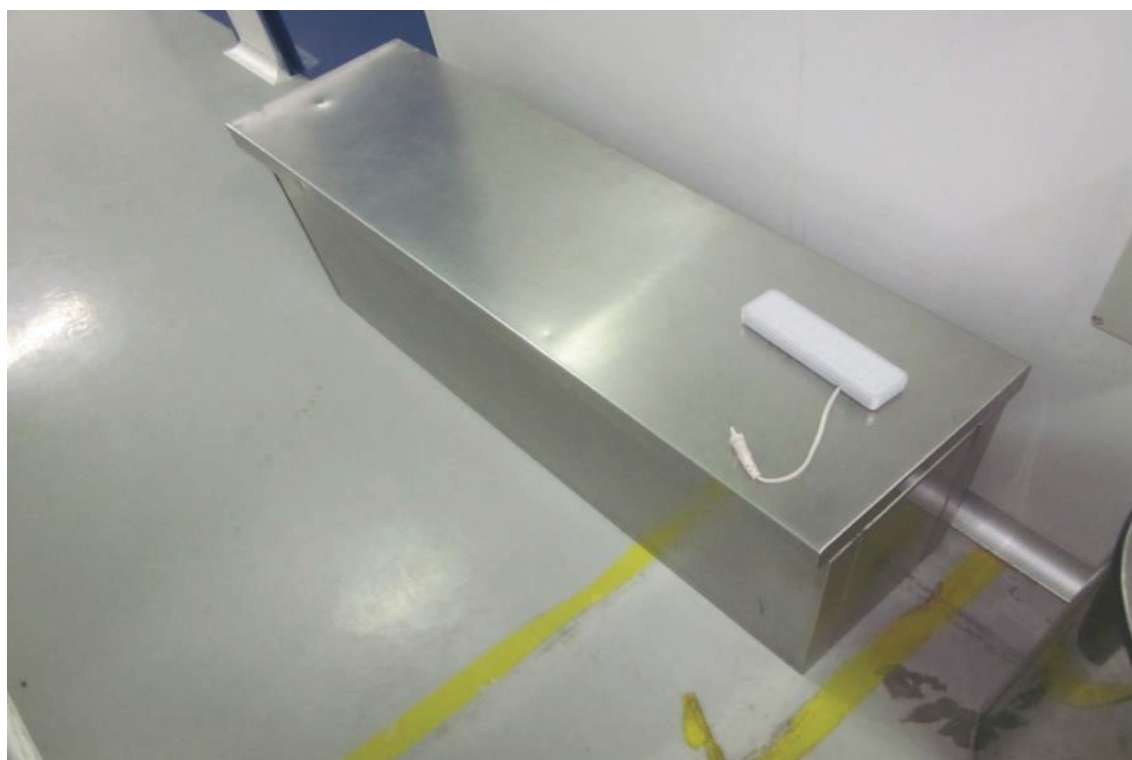
ITENS 2,136 / 2,137 - BANCO BAÚ EM INOX E LUMINÁRIA DE EMERGÊNCIA FOXLUX
