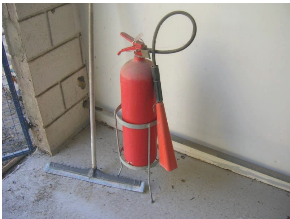
ITEM 1,237 - EXTINTOR DE CO2
