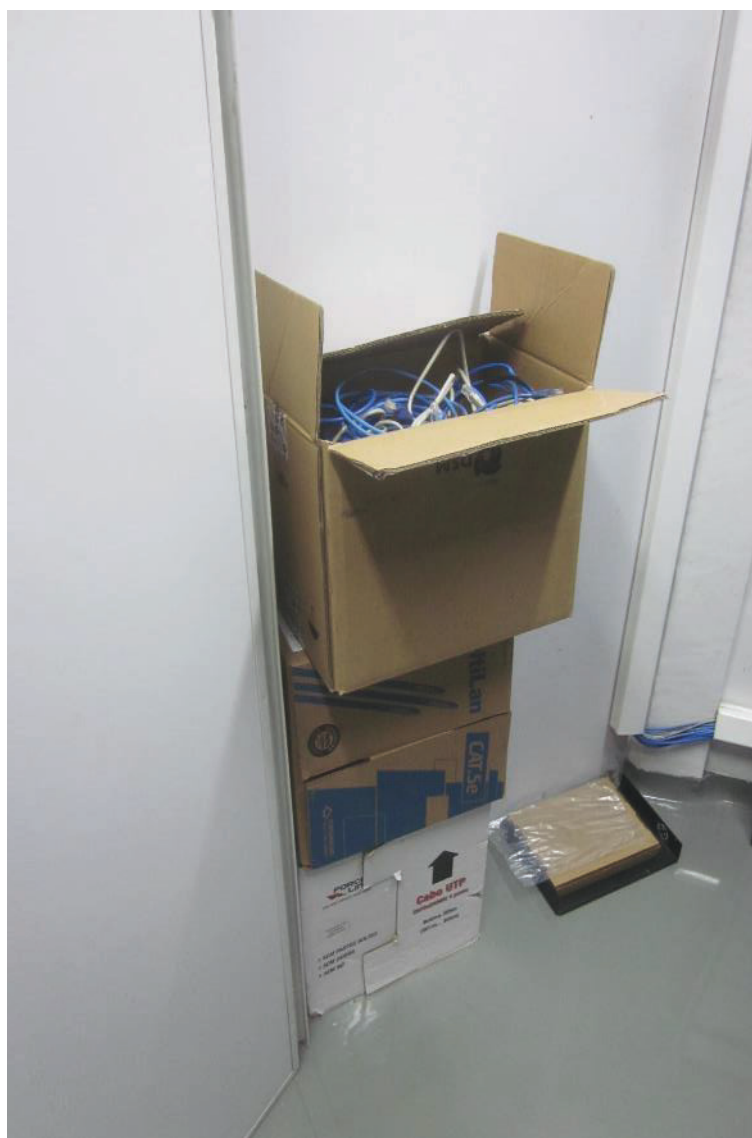
ITENS 2,024 / 2,025 / 2,026 - DIVERSOS CABOS DE REDES MONTADOS, CABO DE REDE (CAIXA) FURUKAWA, CABO DE REDE (CAIXA) FORCE LINE
