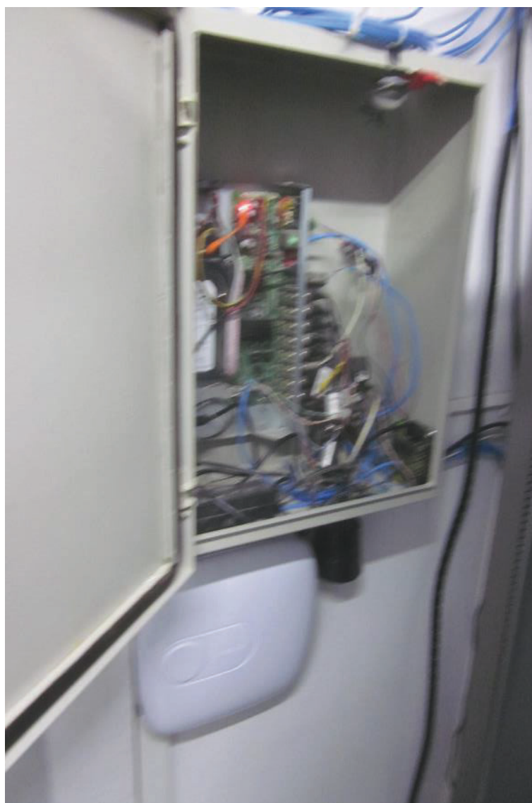
ITENS 2,034 / 2,035 - CENTRAL DE ALARME INTELBRÁS AMT 4010 E DVR16 CANAIS
