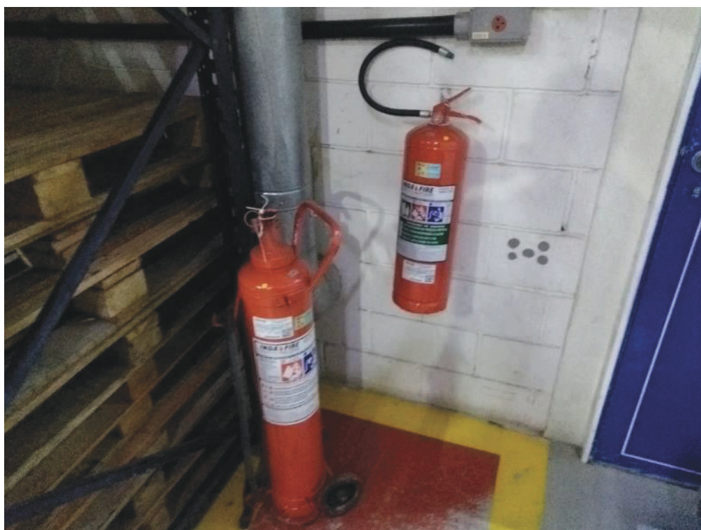
ITENS 1,333 - EXTINTORES DE ÁGUA E PÓ QUÍMICO
