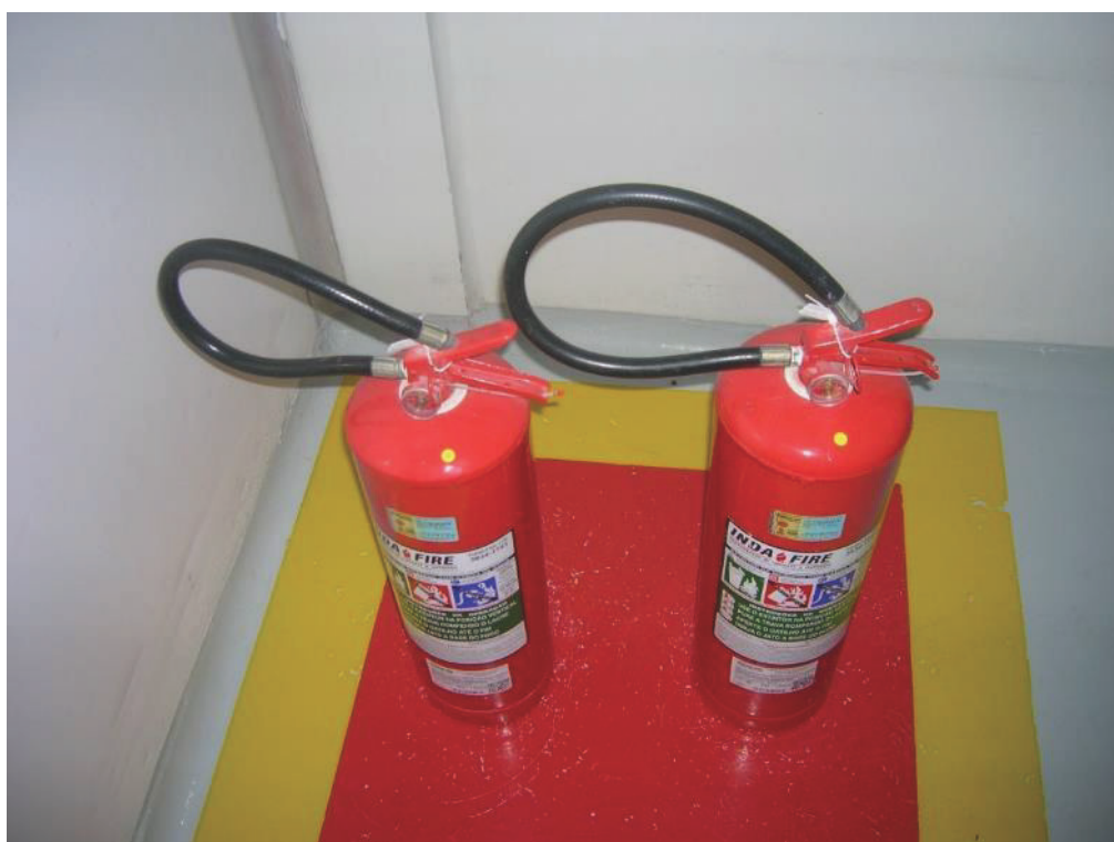
ITENS 1,399 / 1,400 - EXTINTORES DE ÁGUA
