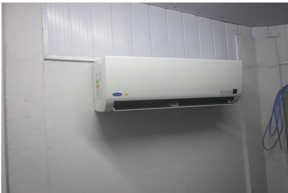
ITEM 2,037 - AR-CONDICIONADO SPLIT CARRIER 9.000 BTUS
