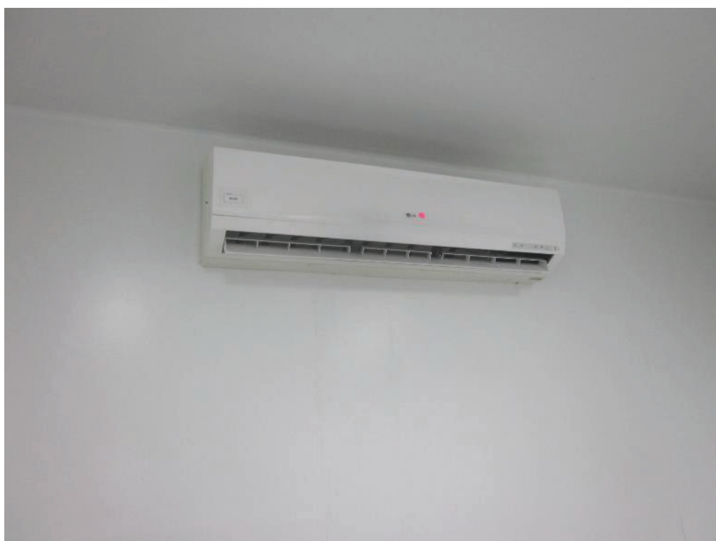
ITEM 1,215 - AR-CONDICIONADO SPLIT LG 18.000 BTUS
