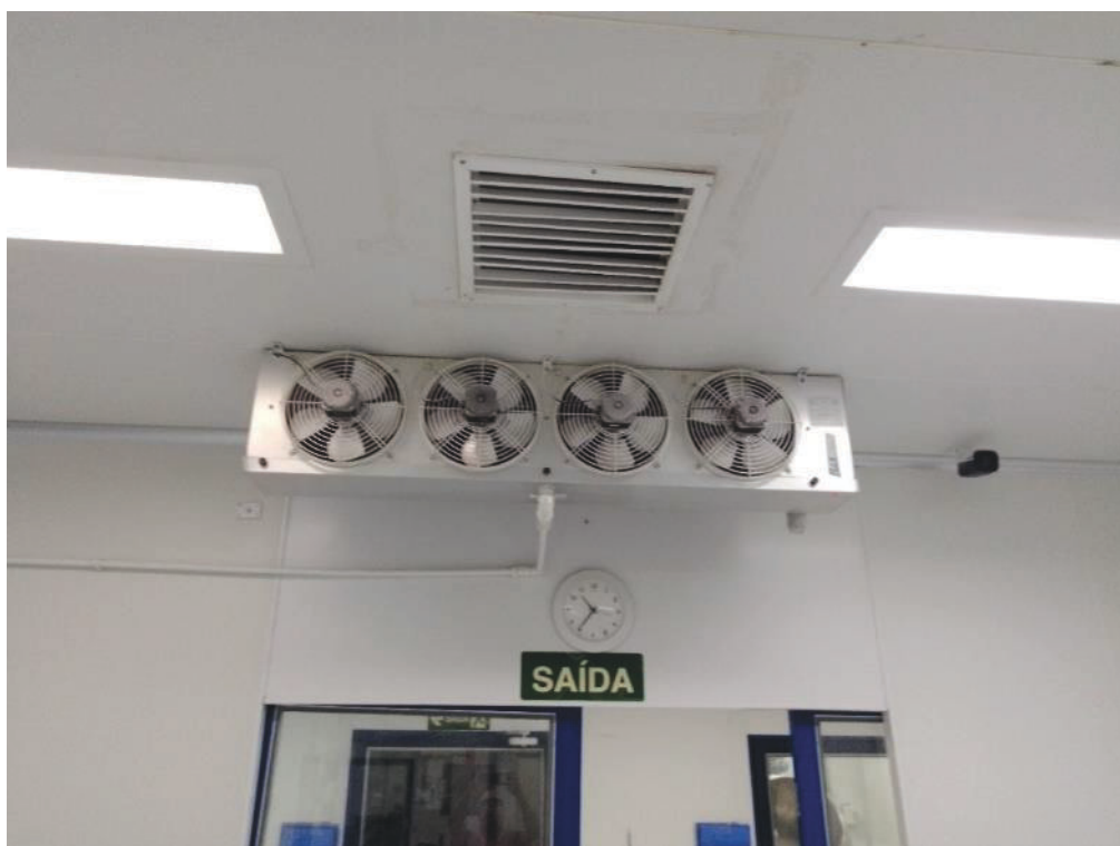
ITENS 1,530 / 1,531 - RELÓGIO DE PAREDE E RESFRIADOR DE TETO HEATCRAFT
