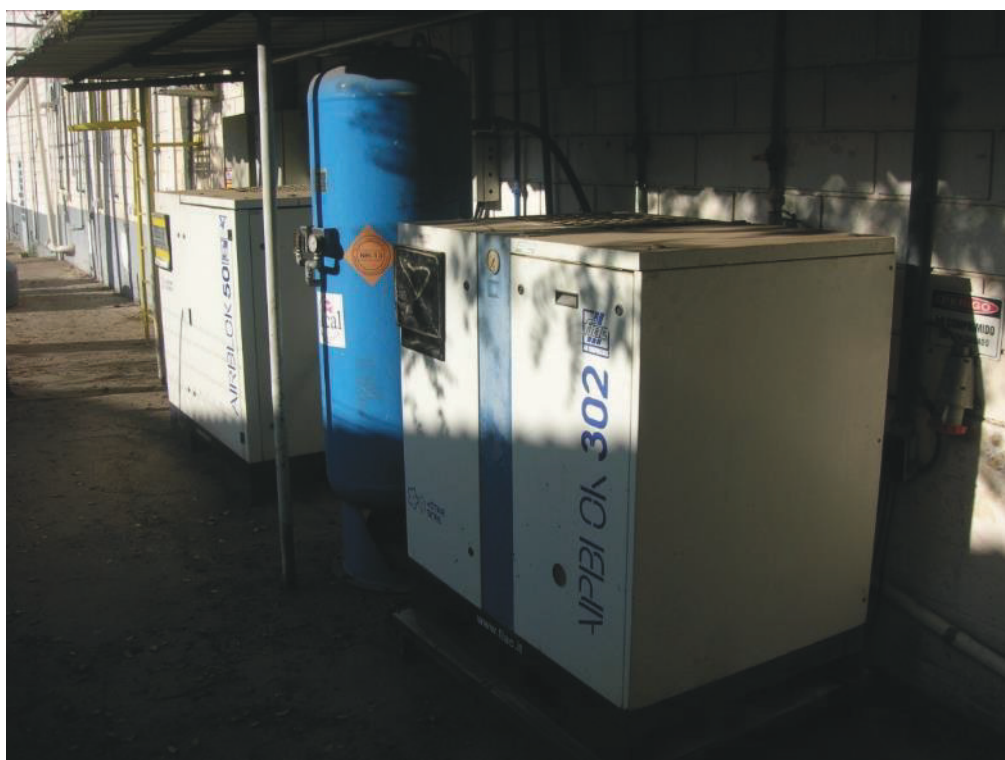
ITENS 1,278 / 1,279 / 1,280 - COMPRESSOR DE AR TIPO PARAFUSO E RESERVATÓRIO DE AR COMPRIMIDO ARXO
