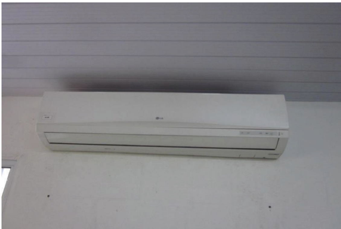
ITEM 1,722 - AR-CONDICIONADO SPLIT LG 24.000 BTUS
