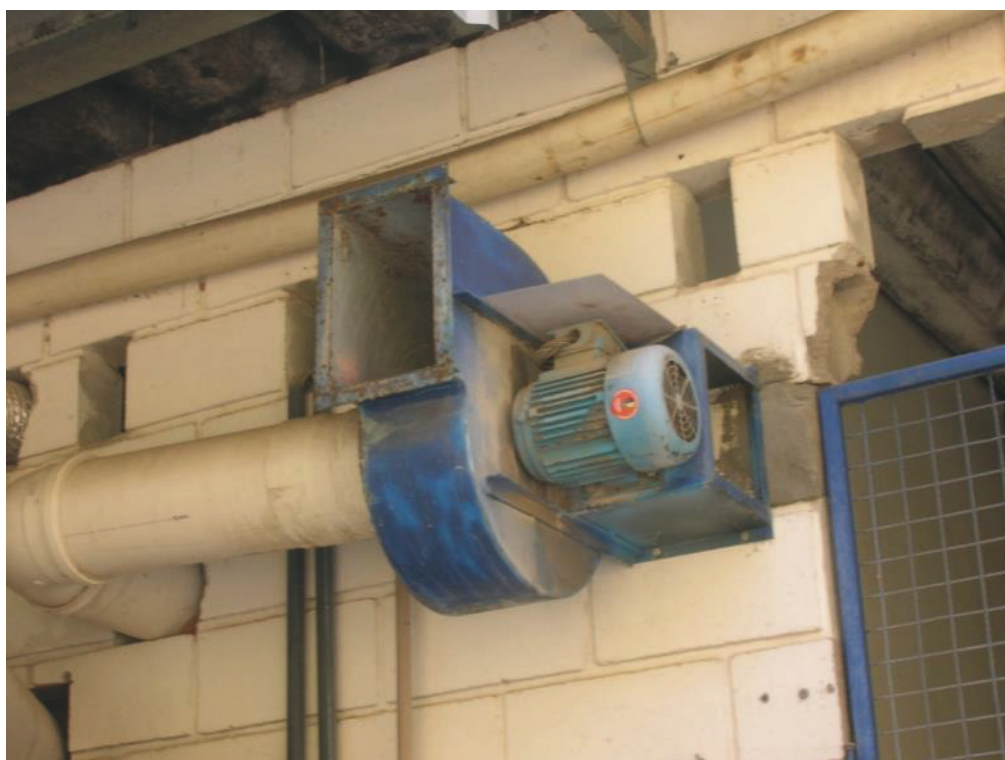
ITEM 1,242 - EXAUSTOR CENTRÍFUGO MOTOR 3 CV
