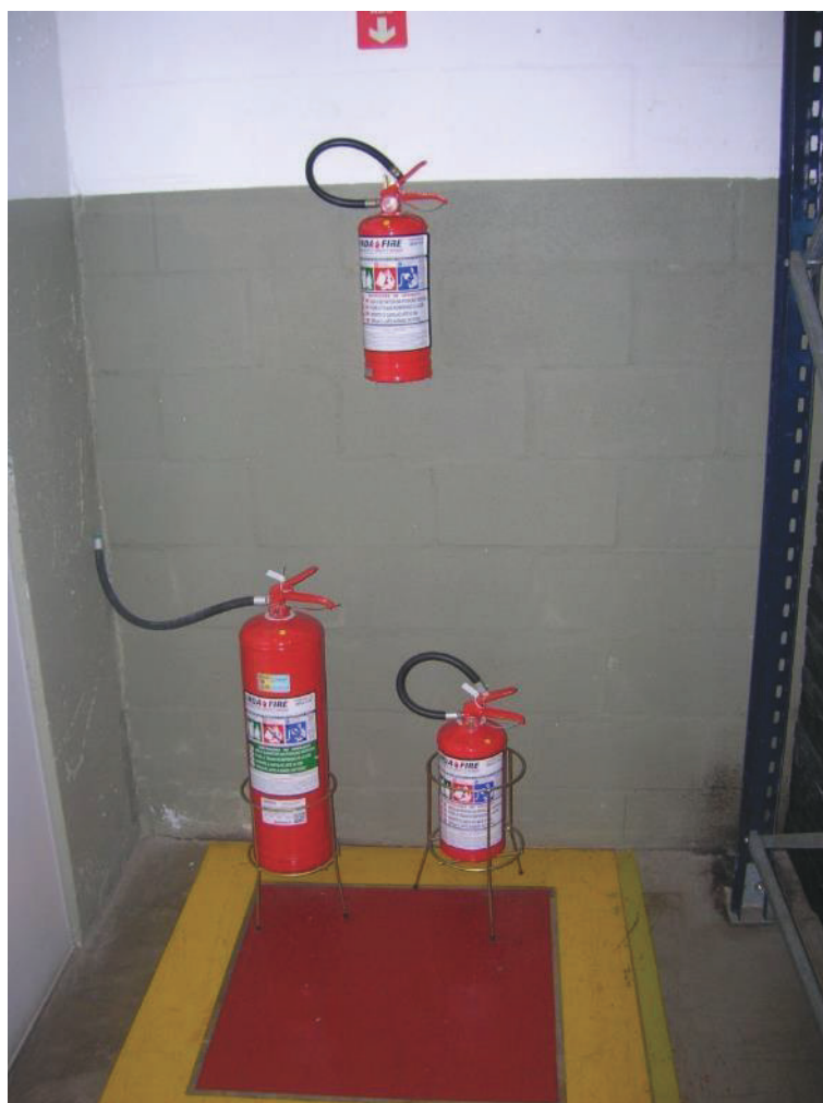
ITENS 1,047 / 1,048 / 1,049 - EXTINTORES DE PÓ QUÍMICO E ÁGUA
