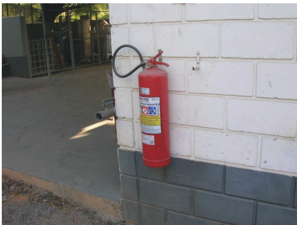
ITEM 1,254 - EXTINTOR DE ESPUMA MECÂNICA
