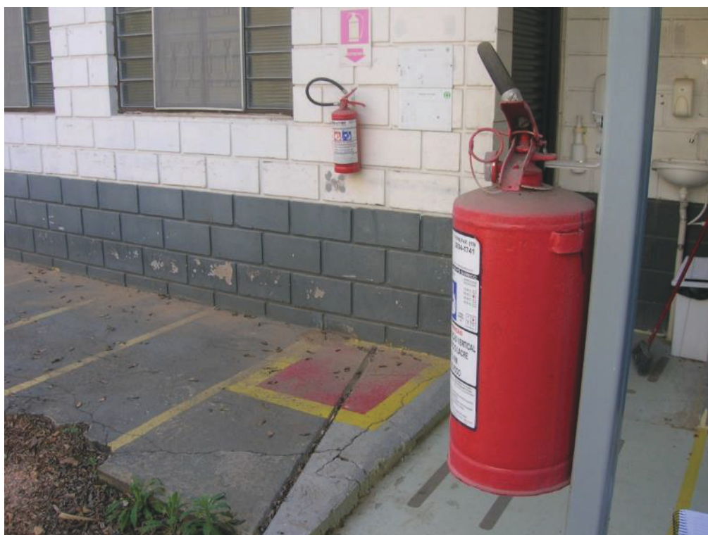
ITENS 1,252 / 1,253 - EXTINTORES DE PÓ QUÍMICO
