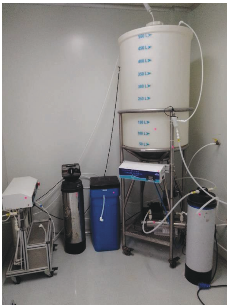
ITEM 1,462 - SISTEMA DE OSMOSE REVERSA COMPOSTO DE: TANQUE EM PEAD 500 L, ESTERILIZADOR POR UV WONDER, BOMBA D'ÁGUA INOX CHINA COM MOTOR 750 W, CONDUTIVIMETRO GEHAKA, SISTEMA DE FILTRAGEM POR MEMBRANA, ESTRUTURA MÓVEL EM INOX, FILTRO ABRANDADOR, FILTRO DEIONIZADOR E CAIXA DE SALMOURA
