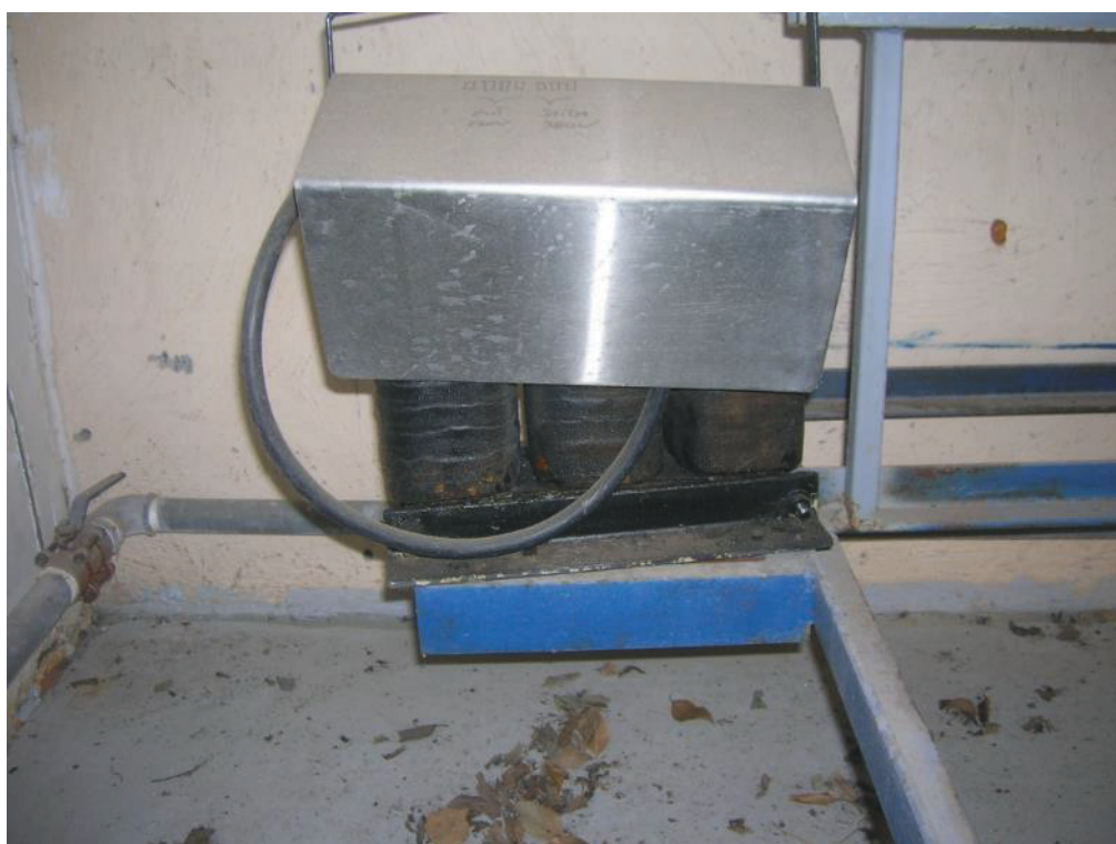
ITEM 1,239 - TRANSFORMADOR TRIFÁSICO PORTÁTIL
