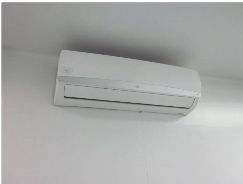
ITEM 1,137 - AR-CONDICIONADO SPLIT CARRIER 22.000 BTUS
