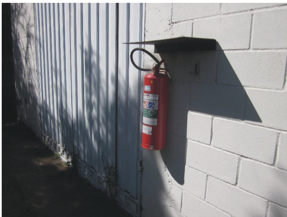
ITEM 1,223 - EXTINTOR DE ÁGUA
