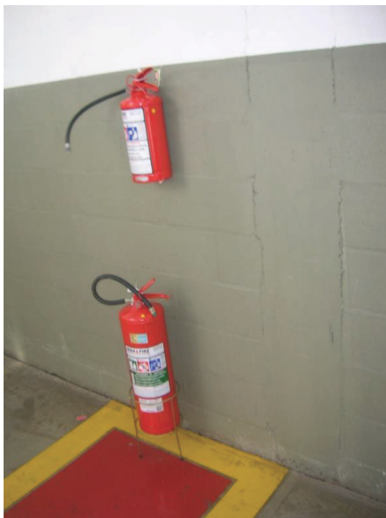
ITENS 1,005 / 1,006 - EXTINTORES DE PÓ QUÍMICO E ÁGUA
