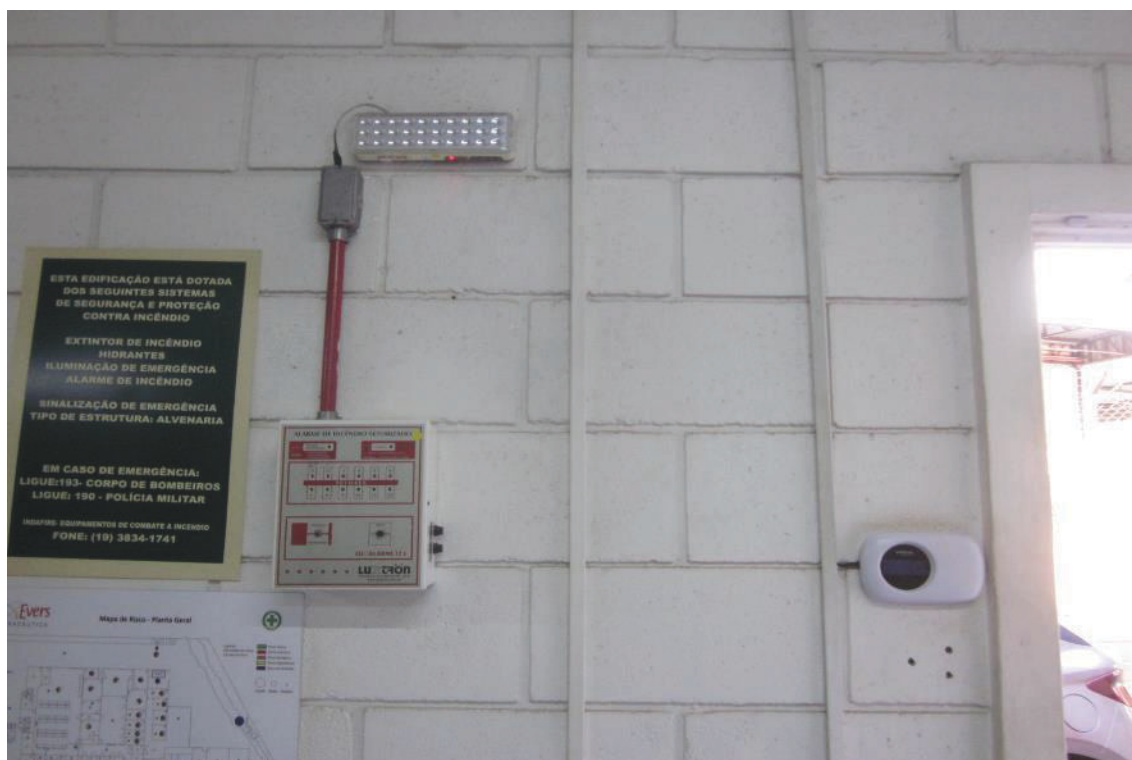
ITENS 1,757 / 1,758 / 1,759 - CENTRAL DE ALARME LUXTRON LUX ALARME RL, LUMINÁRIA DE EMERGÊNCIA FOXLUX E TECLADO P/ CENTRAL DE ALARME INTELBRÁS XAT 4000 LCD
