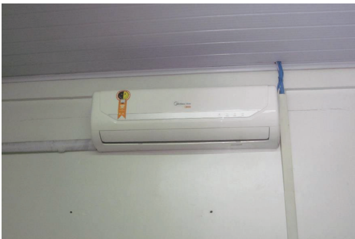
ITEM 2,076 - AR-CONDICIONADO SPLIT MIDEA 17.000 BTUS
