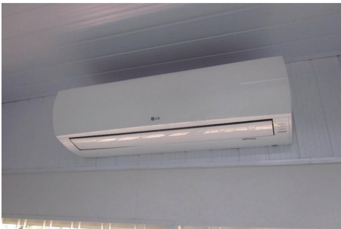
ITEM 1,995 - AR-CONDICIONADO SPLIT LG 17.000 BTUS
