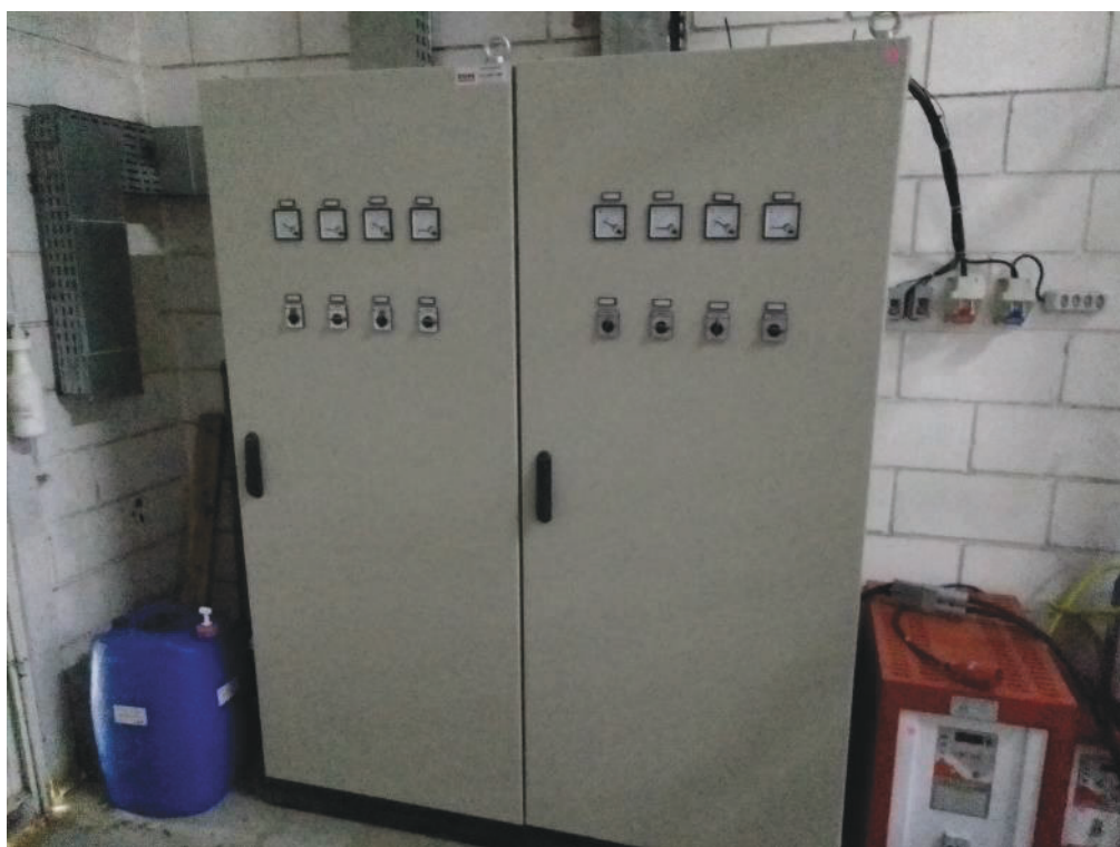
ITEM 1,282 - PAINEL DE DISTRIBUIÇÃO DE FORÇA
