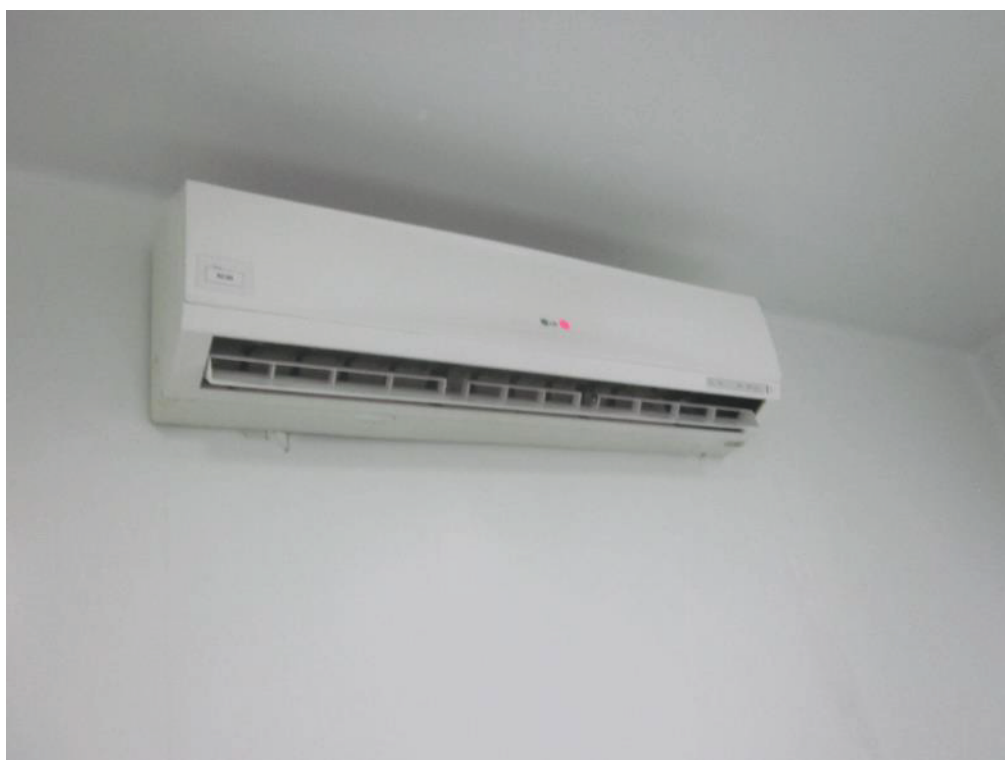
ITEM 1,190 - AR-CONDICIONADO SPLIT LG 18.000 BTUS
