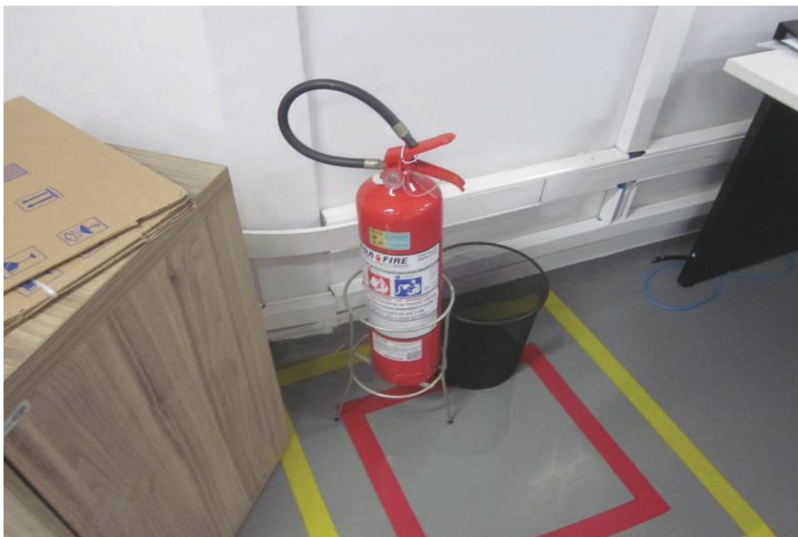
ITEM 1,991 - EXTINTOR DE PÓ QUÍMICO
