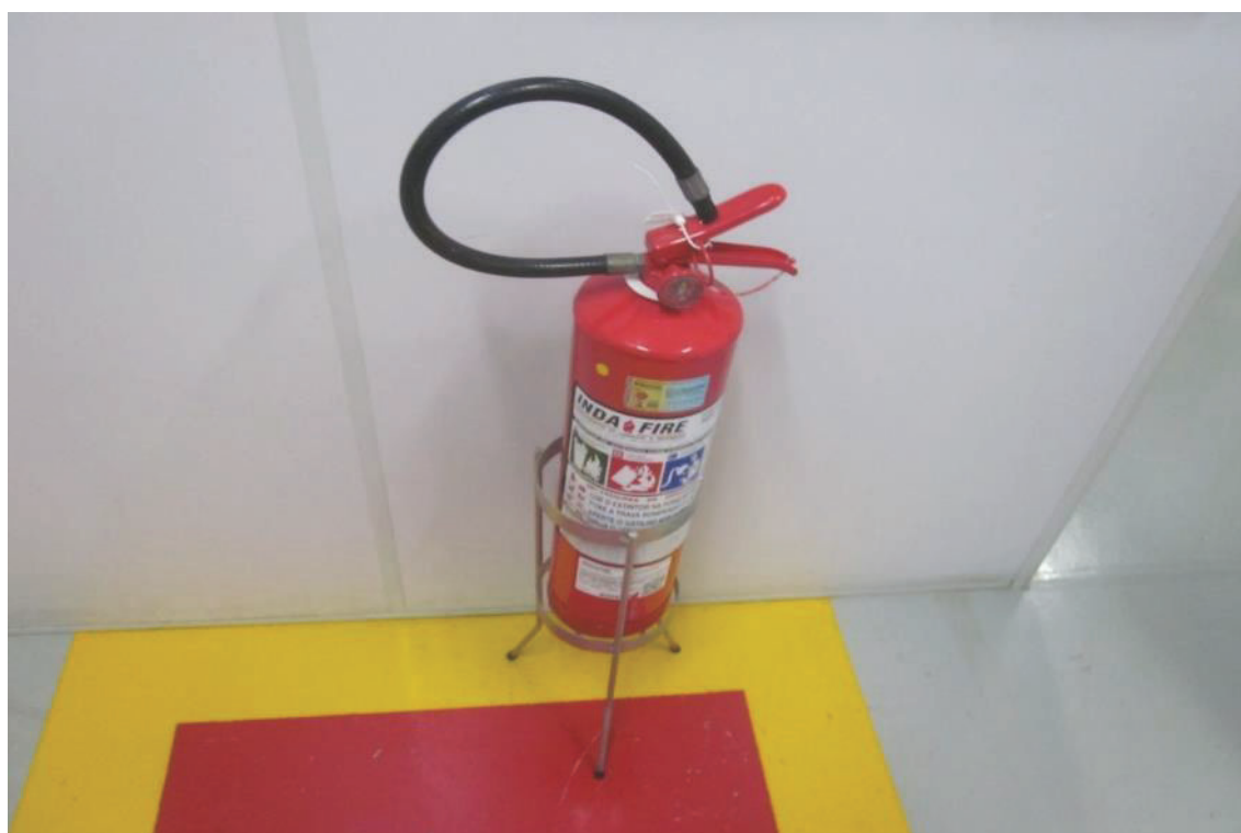
ITEM 2,133 - EXTINTOR DE PÓ QUÍMICO
