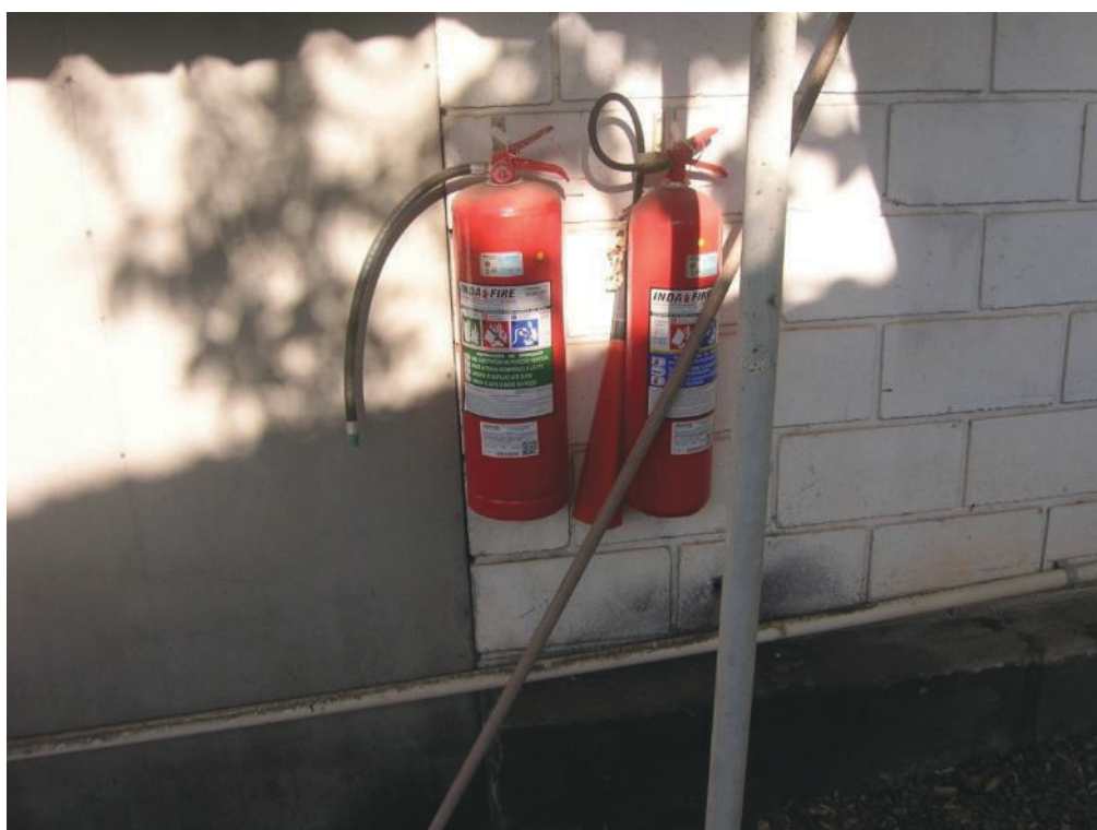
ITEM 1,275 - EXTINTOR DE ÁGUA
