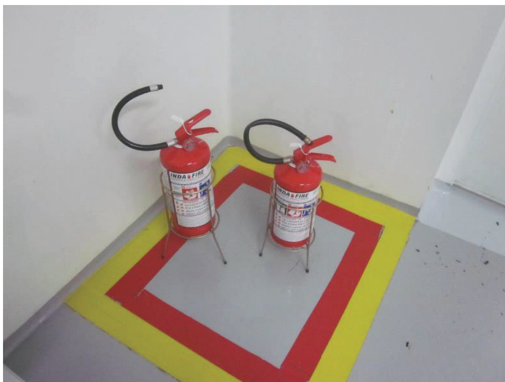
ITENS 1,108 / 1,109 - EXTINTORES DE PÓ QUÍMICO
