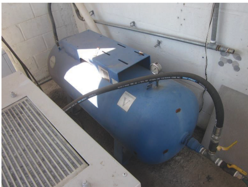
ITEM 1,217 - RESERVATÓRIO DE AR COMPRIMIDO
