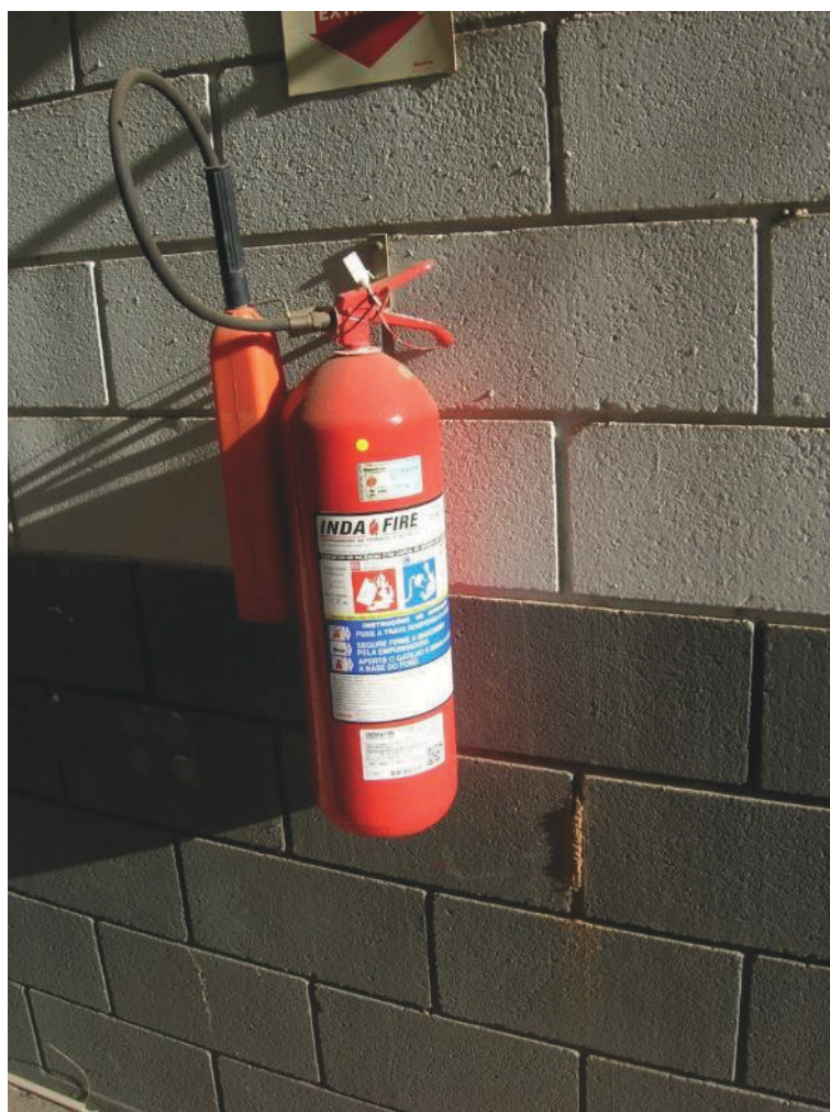
ITEM 1,281 - EXTINTOR DE CO2
