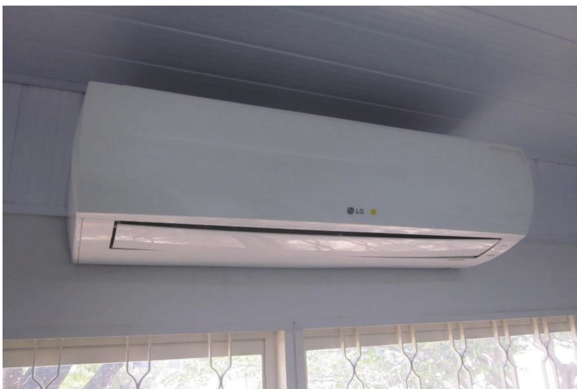
ITEM 1,883 - AR-CONDICIONADO SPLIT LG 17.000 BTUS
