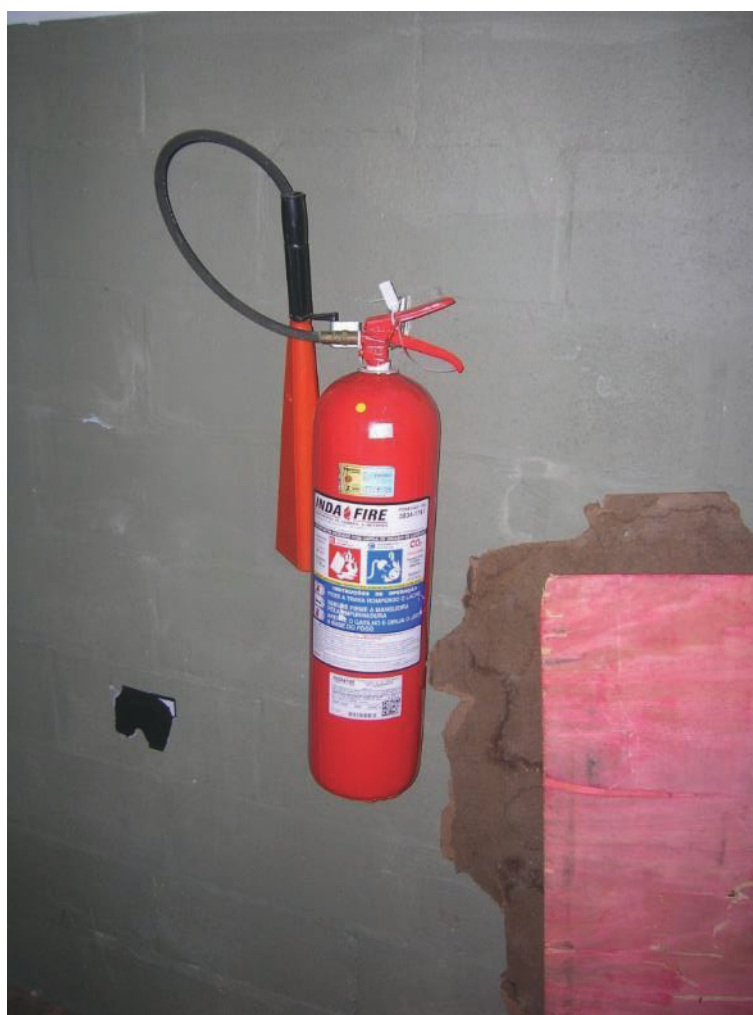
ITEM 1,039 - EXTINTOR DE CO2
