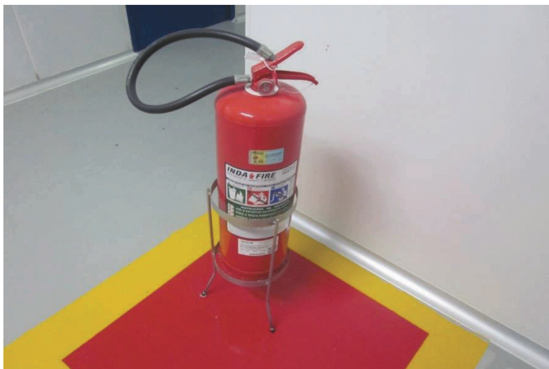
ITEM 2,140 - EXTINTOR DE ÁGUA
