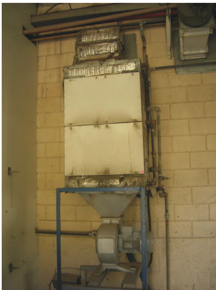
ITEM 1,238 - CENTRAL DE AR-CONDICIONADO TIPO FANCOIL
