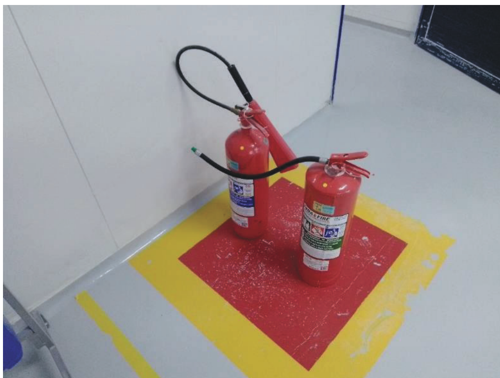
ITENS 1,532 / 1,533 - EXTINTORES DE ÁGUA E CO2
