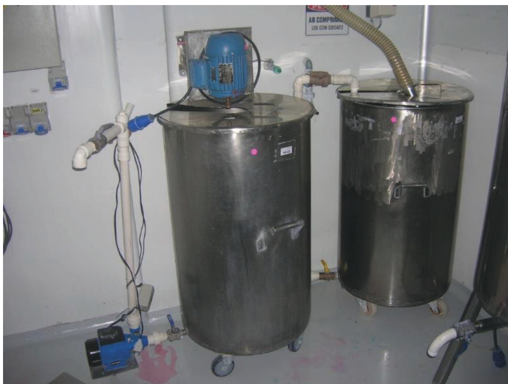
ITEM 1,425 / 1,426 / 1,427 - TANQUE EM INOX E AGITADOR FIXO NA PAREDE
