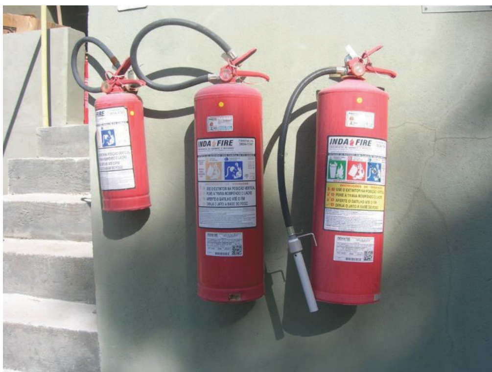
ITENS 1,249 / 1,250 - EXTINTORES DE PÓ QUÍMICO E ESPUMA MECÂNICA
