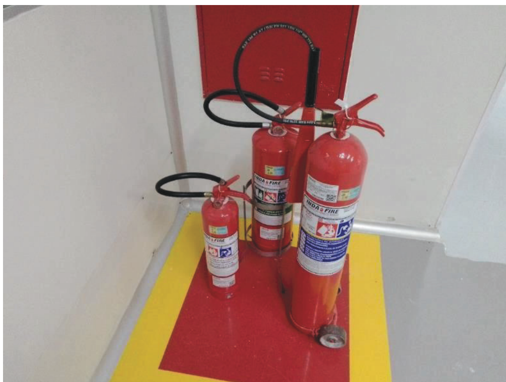
ITEM 1,387 / 1,388 / 1,389 - EXTINTORES DE PÓ QUÍMICO E ÁGUA
