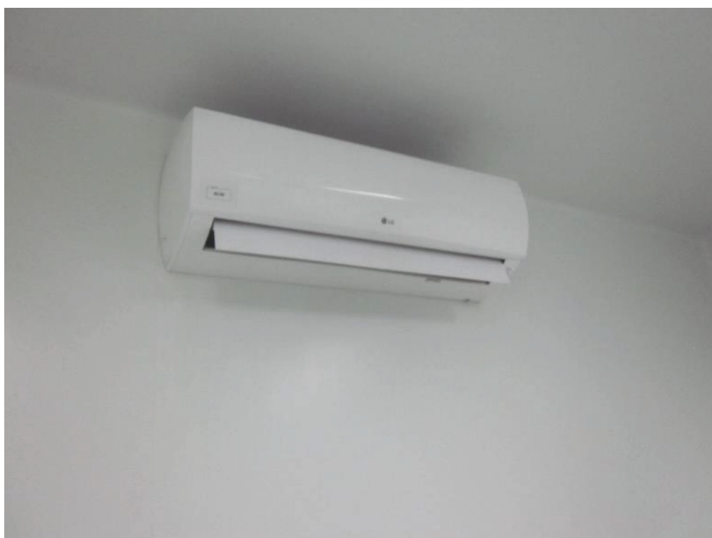
ITEM 1,201 - AR-CONDICIONADO SPLIT LG 17.000 BTUS
