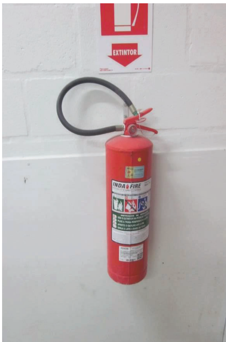
ITEM 2,254 - EXTINTOR DE ÁGUA
