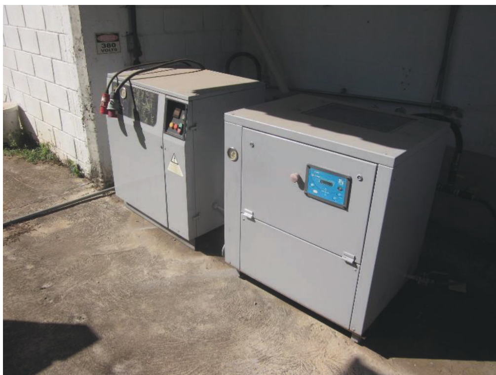
ITENS 1,218 / 1,219 - COMPRESSORES DE AR
