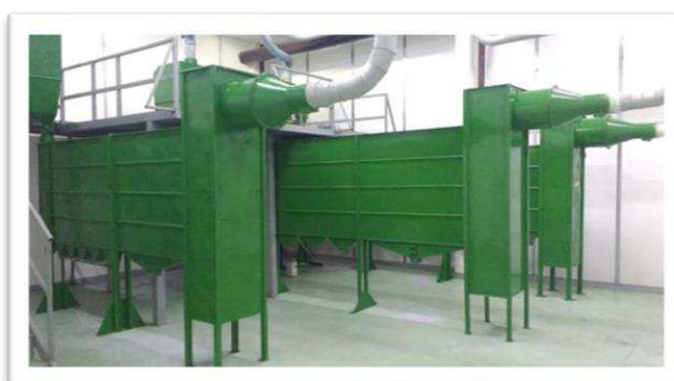
Figura 06 – Túnel de vento
