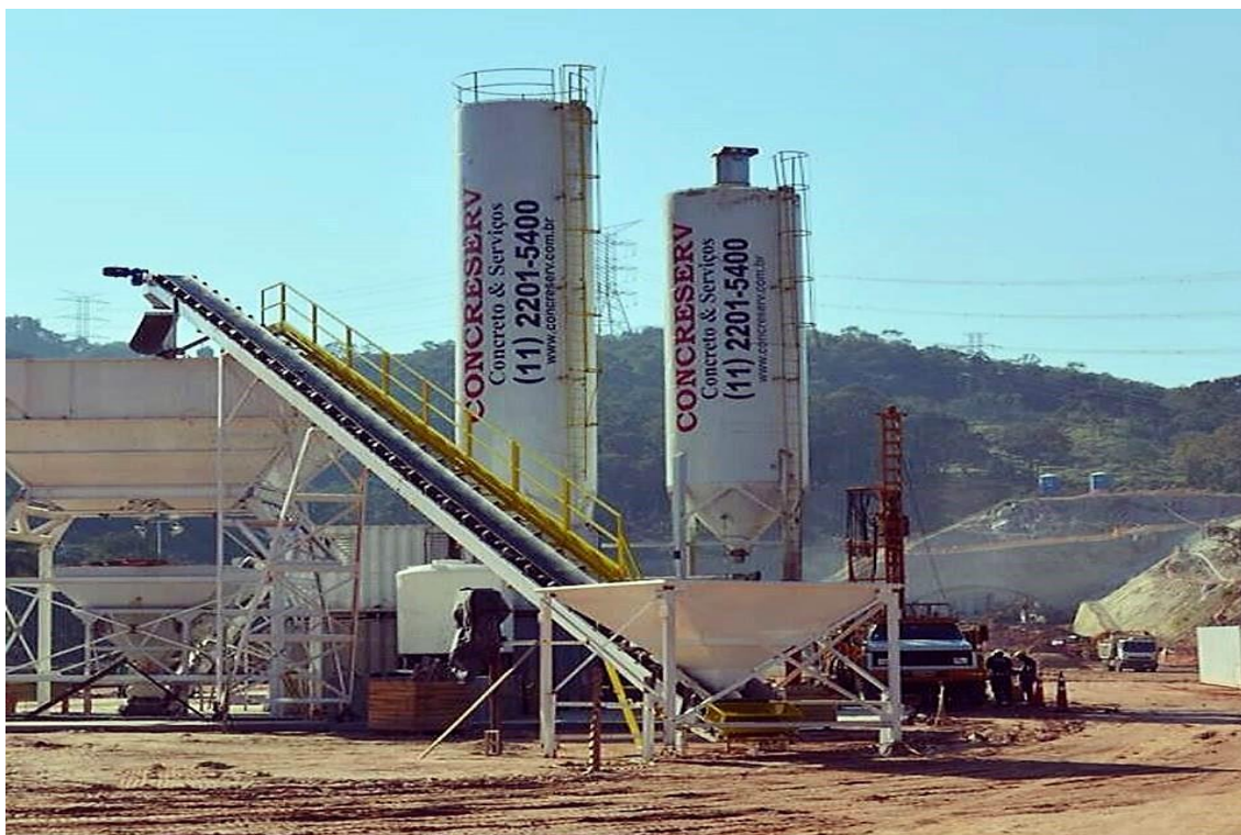
Foto: Usina Tow-go + Silo 80 ton.
