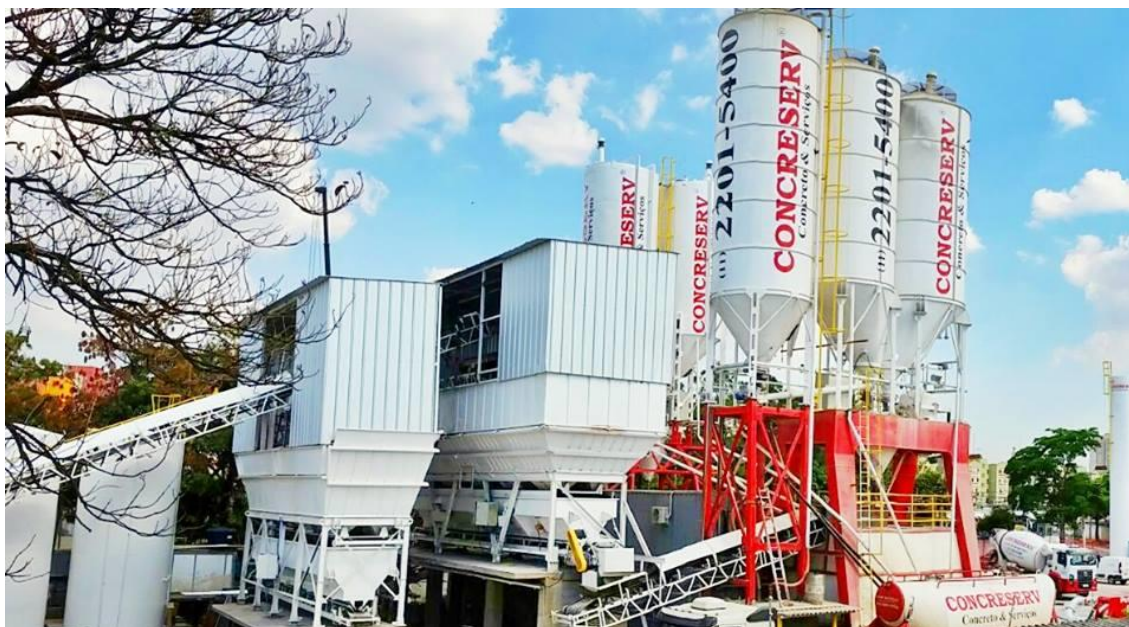
Foto: Usina P5 + Silos 100 ton.
