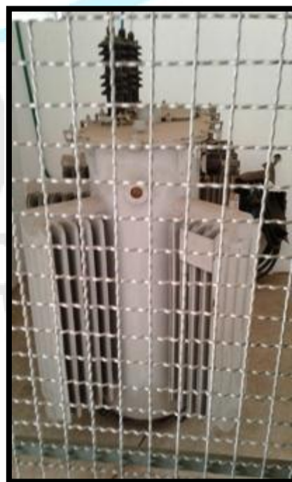
PAT. 01194 - TRANSFORMADOR TRIFÁSICO,225 KVA
