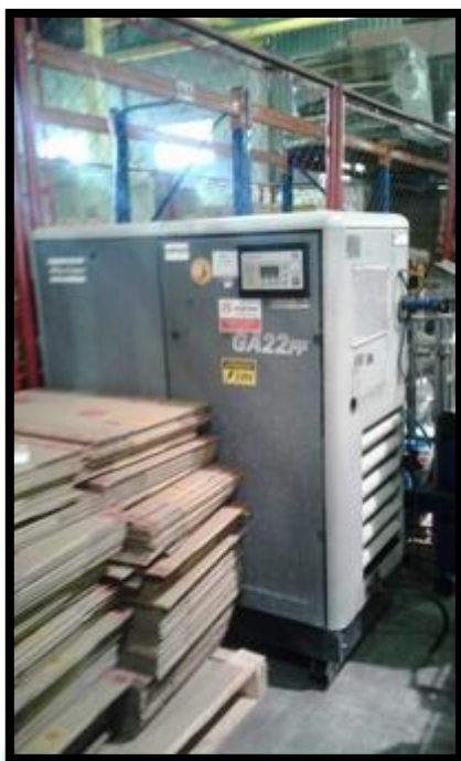
PAT. 00704 - COMPRESSOR DE AR ,ATLAS COPCO,GA22FF
